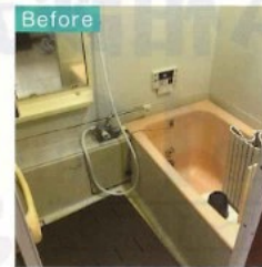
0.5坪用の浴槽は狭かった...
