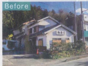
Before 店舗だった部分を解体。 外壁塗装を施し、 まるで違う外観に。
